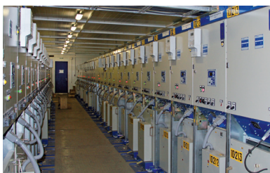
КРУ в модульном здании
