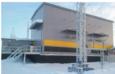
Закрытое распределительное устройство с КРУЭ-СЭЩ 110 кВ
