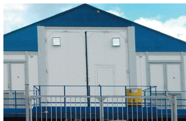
Закрытое распределительное устройство ЗРУ-СЭЩ 20/6 (6/20) кВ
