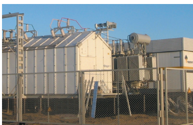
Открытое распределительное устройство ОРУ-СЭЩ 35/6 кВ
